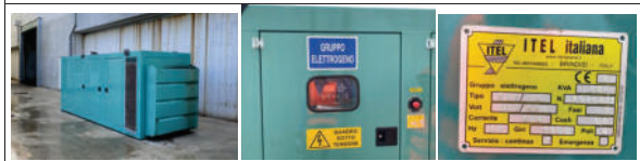
Gruppo elettrogeno da 350 kVA (in esercizio h24)
