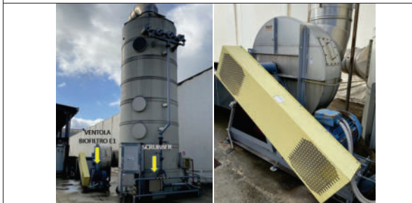
Ventola biofiltro E1 e Scrubber
