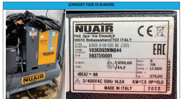
Compressore d'aria NUAIR SIRIO ES da 8 bar (a servizio del filtro a maniche E3 – Reparto vagliatura Ø10-Ø28)
